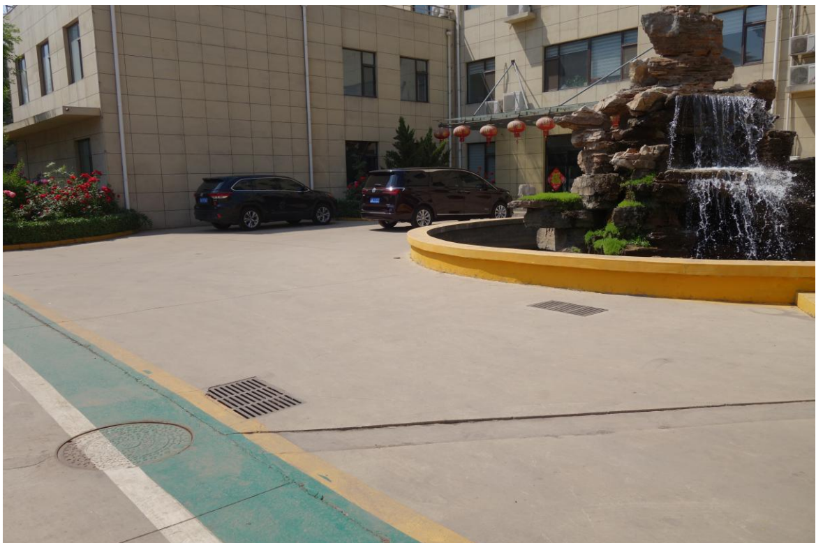
厂区内排水管网（拍摄时间 2021 年 6 月）
